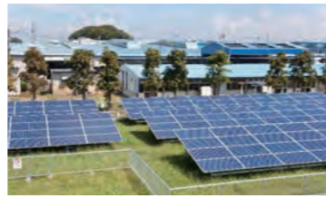
小山工場太陽光発電システムの一部
